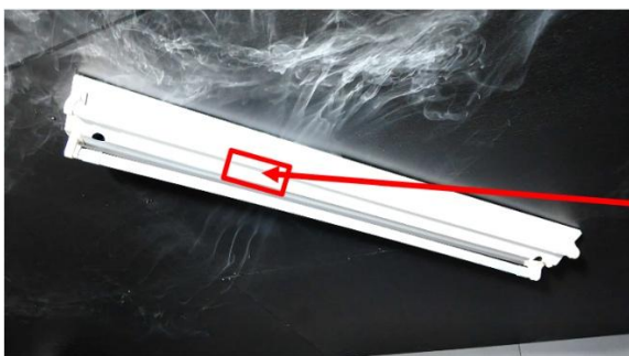
蛍光灯器具から発煙する様子 (再現実験)
