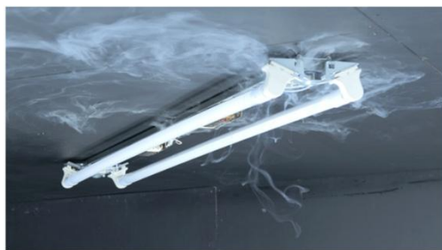
蛍光灯器具から発煙する様子 (カバーを外した状態での再現実験)
