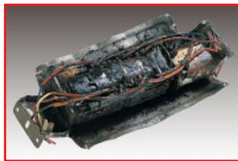
劣化が進んだ安定器の例
