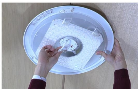
天井に引掛シーリングが設けられていれば、自分でLED照明に交換することができます。
