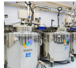
▶ 凍結保存の設備
