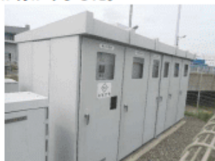
【図1】キュービクル(高圧受電設備)
