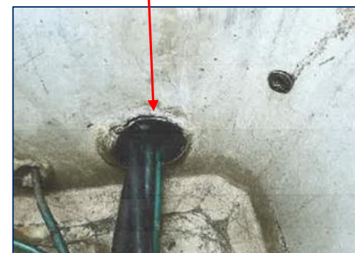
水トリーが発生した地中埋設高圧引込ケーブル（約75m地点）
