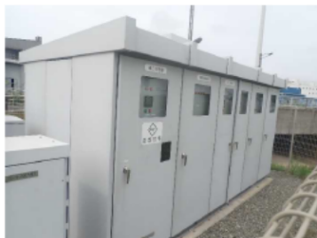
キュービクル（高圧受電設備）
