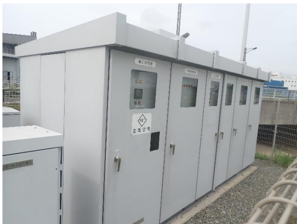
【図1】キュービクル(高圧受電設備)
